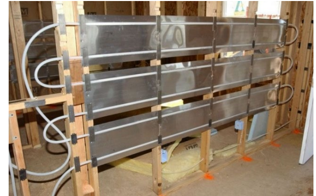
In-wall radiant (NREL)
